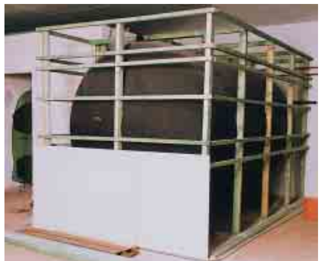
Hydroaccumulateur en acier entouré de parois qui peuvent être remplis par exemple avec des copeaux de bois.
